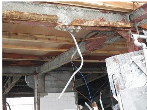
建物に残存した吹付け材
