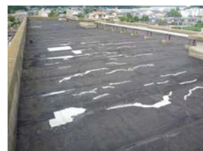
長府前八幡(2) (劣化箇所)
