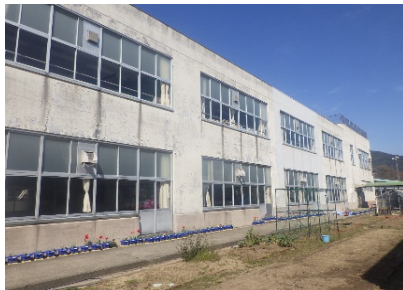
【外壁落下防止処置前】
