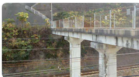
老朽化した橋梁
