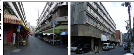
老朽化した竹崎改良住宅
