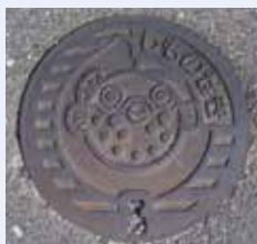
公共汚水ます
