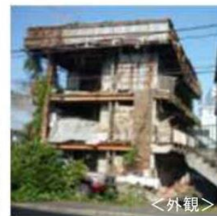
外壁が崩落等した事例
