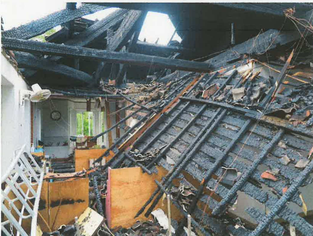
写真 3 同 屋根崩落の状況
