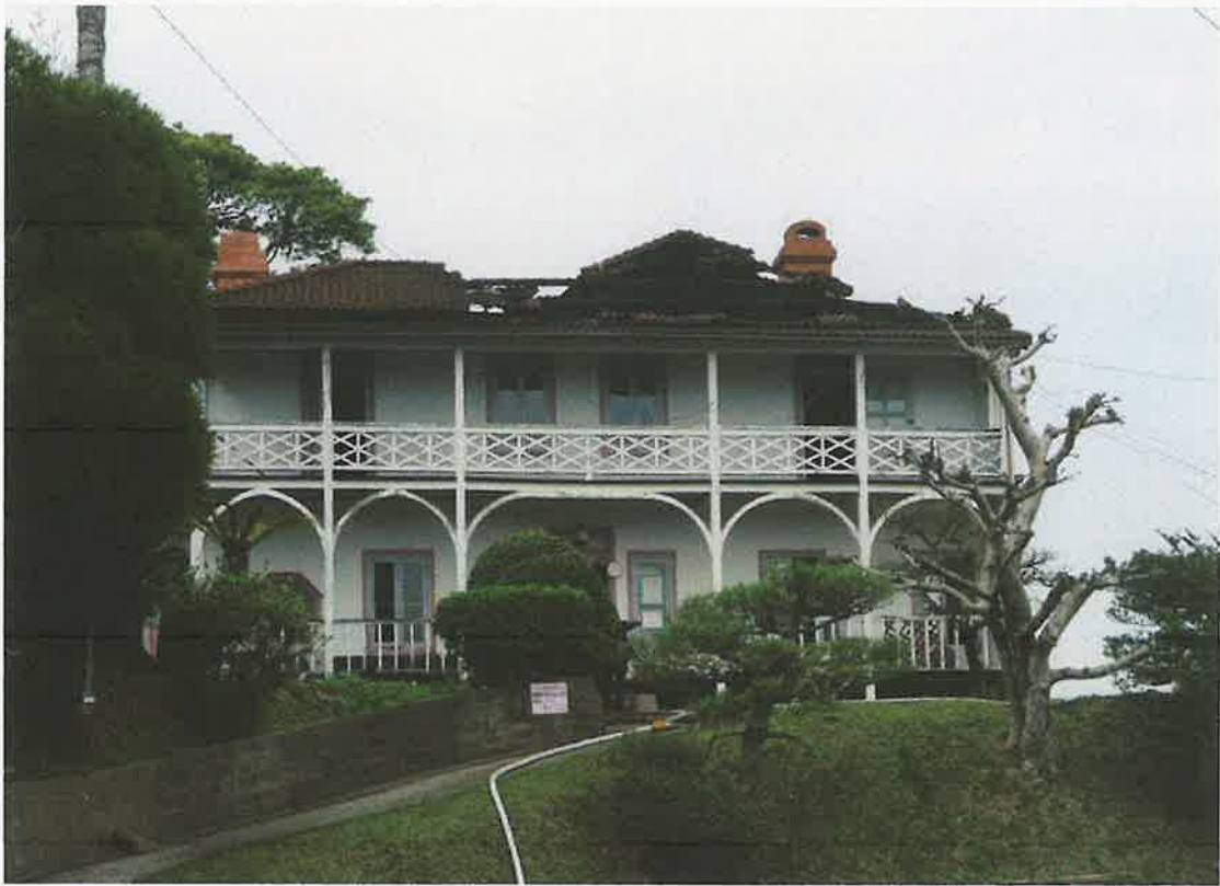
写真1 めぐみ幼稚園第二園舎（被災後）
