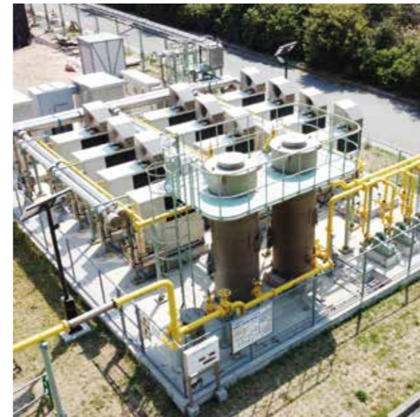
山陰終末処理場消化ガス発電事業
