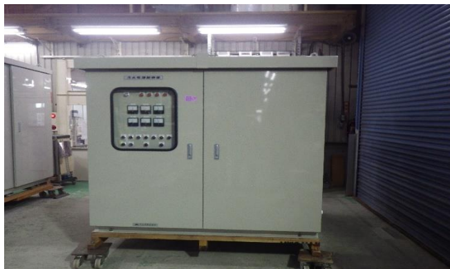
同社製造の汚水処理制御盤
