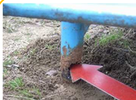
滑降部 基礎支柱の劣化 (健全度判定“D”)
