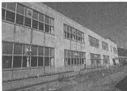
【外壁落下防止処置前】
