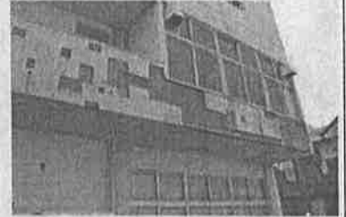
（老朽化が進む安岡公民館）
