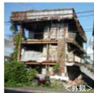
外壁が崩落等した事例
