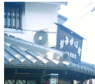
▲目立たないように看板の裏に隠した室外機
