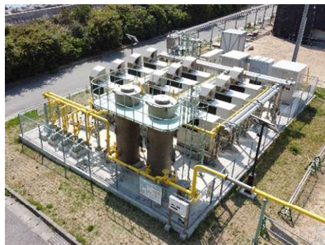
山陰終末処理場消化ガス発電事業
