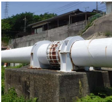
老朽化した送水管
