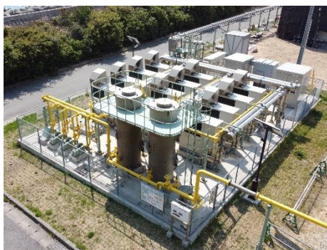
山陰終末処理場消化ガス発電事業
