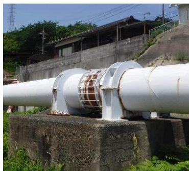
老朽化した送水管
