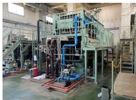
下水道 老朽化した設備（山陰終末処理場脱水機）
