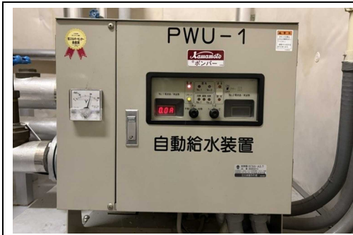
既設 自動給水装置
