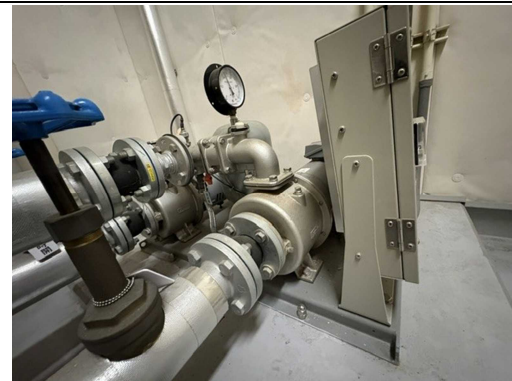
既設 ポンプ 左斜め
