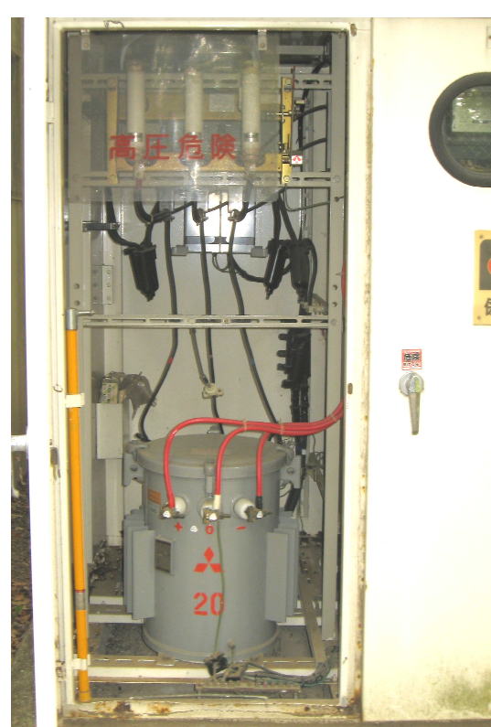
交換対象変圧器 (PCB 含有)
