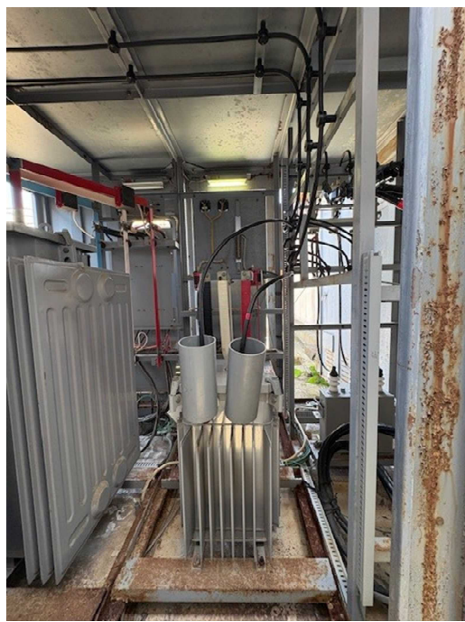
交換対象変圧器 (PCB 含有)
