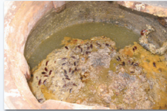
油が固まり詰まったマンホール このまま放置するとマンホールから汚水が溢れ出し、非常に不衛生になります。
