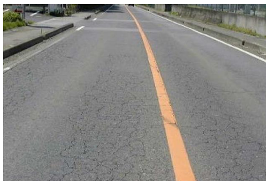
ひび割れ 40%程度の例
